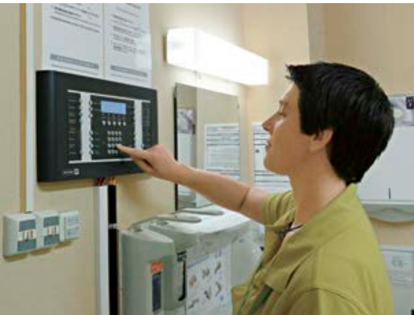
Über die Bedienfelder in den Dienstzimmern hat das Pflegepersonal jederzeit Zugriff auf die Hausalarmanlage und alle Meldungen.
