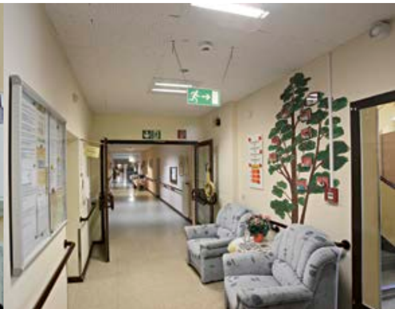
Während die Detektionstechnik eher unauffällig in den Räumen platziert ist, können im Brandfall Rettungsmaßnahmen sofort und vor allem zielgerichtet eingeleitet werden.
